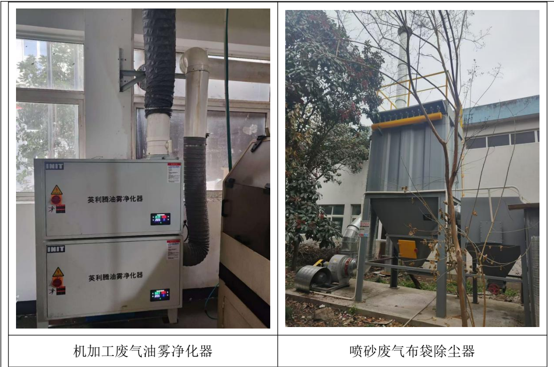
图 3-3 项目废气处理设施
