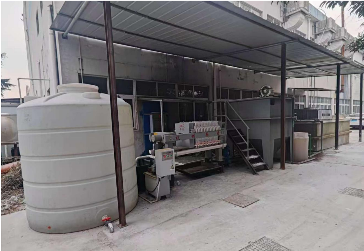
图 3-2 项目生产废水处理设施
