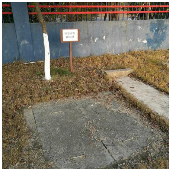
地埋式应急水池
