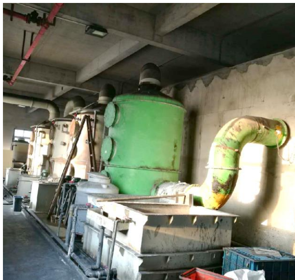
废气喷淋塔（四级碱喷淋）
