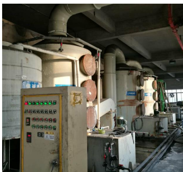
废气喷淋塔（四级碱喷淋）
